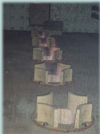
海外・某社 (1) 炉内写真
